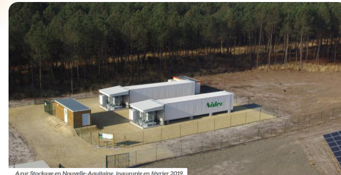
Azur Stockage en Nouvelle-Aquitaine, inaugurée en février 2019.
