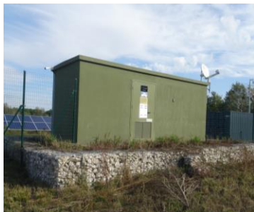
Postes de transformation
