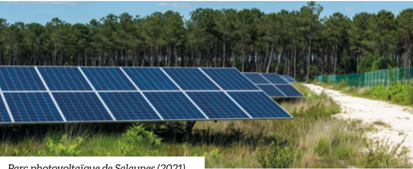
Parc photovoltaïque de Salaunes (2021)
