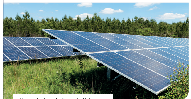
Parc photovoltaïque de Salaunes
