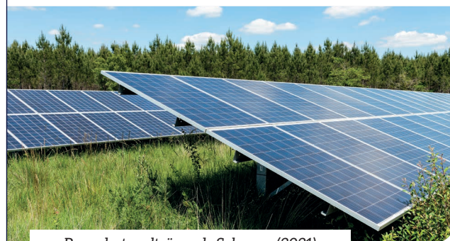
Parc photovoltaïque de Salaunes (2021)
