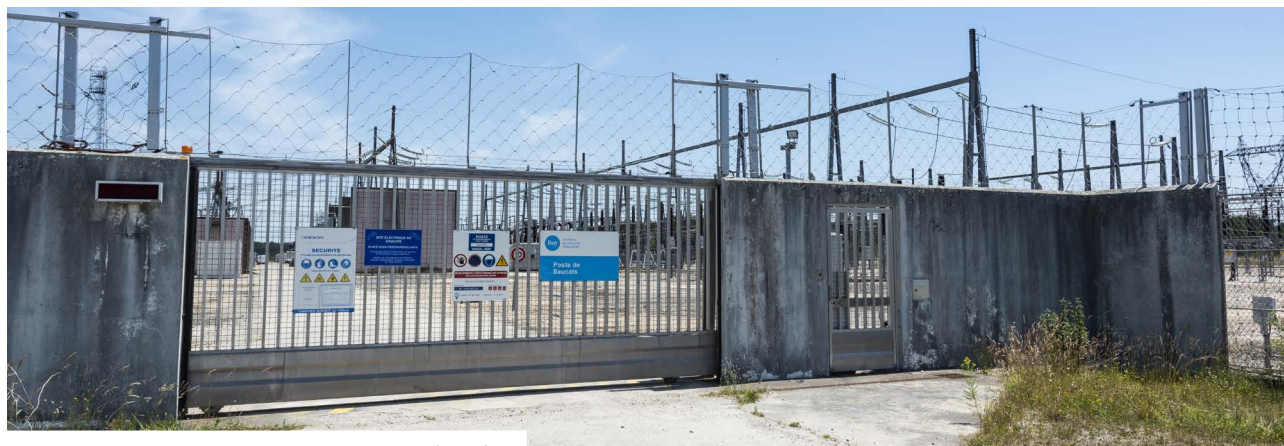
Photographie du poste électrique de Saucats (2021)
