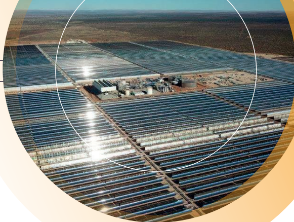
Centrale solaire à concentration sud-africaine Kathu Solar
