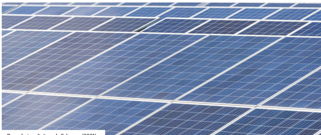
Parc photovoltaïque de Salaunes (2021)
