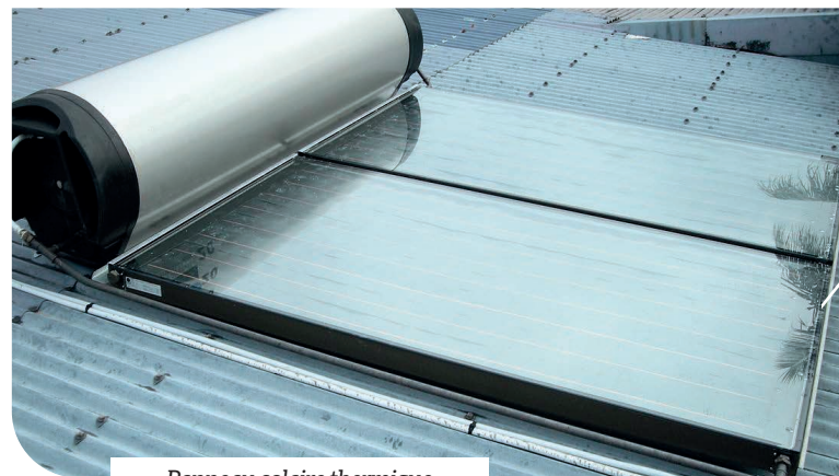
Panneau solaire thermique
